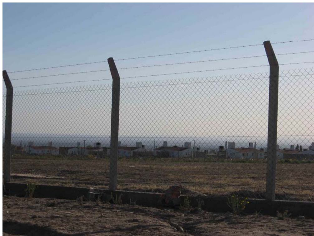
Construcción del barrio minero en donde vivirán los trabajadores de la mina
